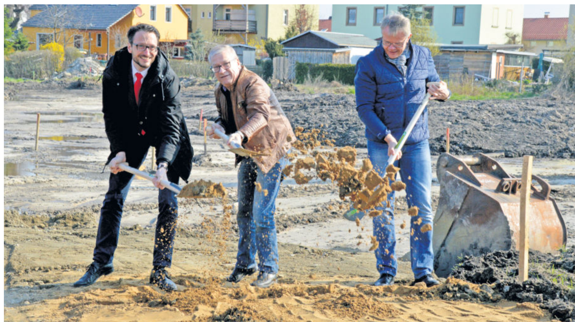
Der symbolische erste Spatenstich. V.l.: Sven Lauter, Geschäftsführer der kommunalen Wohnungsbaugesellschaft mbH; Gerhard Lemm, Oberbürgermeister und Michael Höhne, Niederlassungsleiter Eurovia Dresden.
