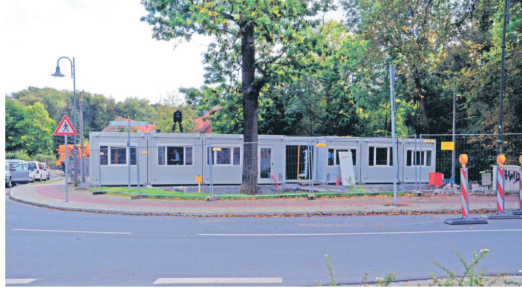
Für das laufende Schuljahr wurden Interimscontainer aufgestellt, um zusätzlichen Raum zum Lernen zu schaffen.
