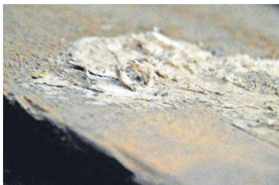
Auf den alten Brettern und Balken ist der Hausschwamm gut zu sehen.
