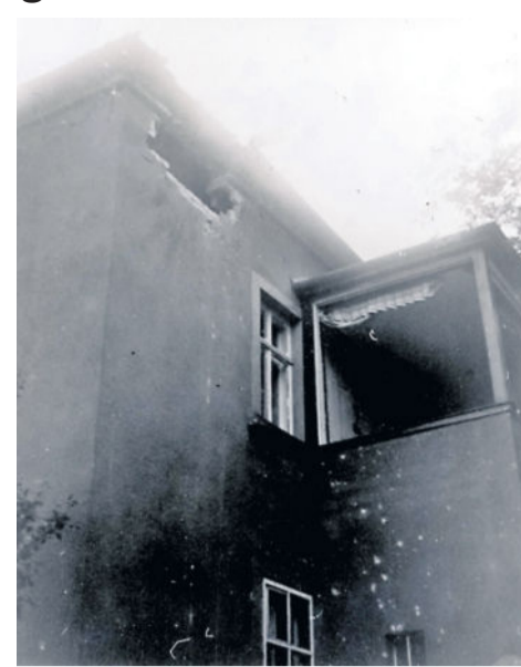
Granateneinschlag an der Nordseite des Hauses Hauptstraße 10
