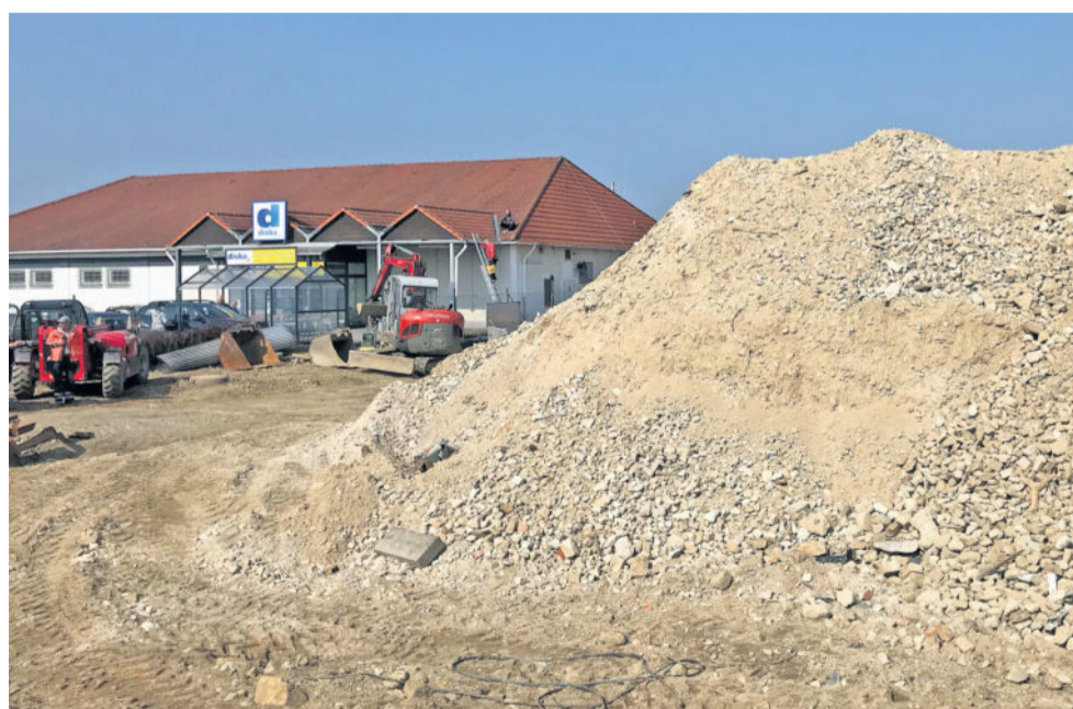
In direkter Nachbarschaft zum jetzigen diska in Langebrück wurde in den vergangenen Wochen das Baufeld für den Neubau frei gemacht. FOTO: Trutschler/meeco Communication Services
