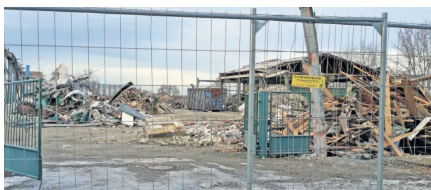
Für einen schnellen Baubeginn hatte der Investor, eine Chemnitz-Unternehmensgruppe, den Abbruch realisiert. Das Bild entstand am 20. Januar 2021.
