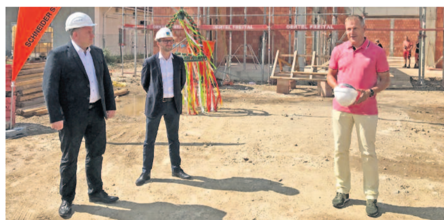
Beim Richtfest mit dabei (von links): Ortsvorsteher Christian-Hartmann, Toni Kunze sowie Bauherr und Investor Frank-Steinert. FOTO: Gebauer
