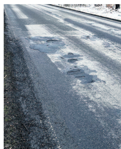
Derzeitige Straßenschäden auf der S 180 FOTOS (3): Ulrich Knöpfle
