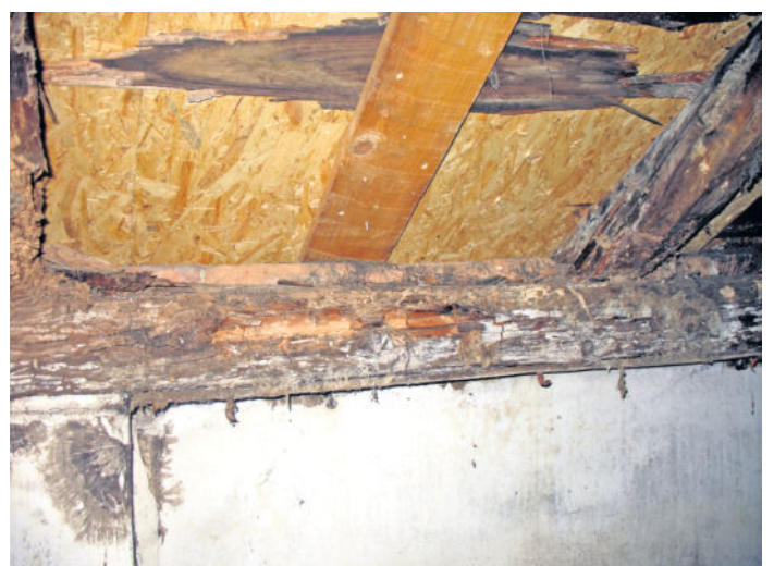
Im Dachstuhl entdeckte man Anfang 2014 erhebliche Mängel, die behoben werden mussten.
