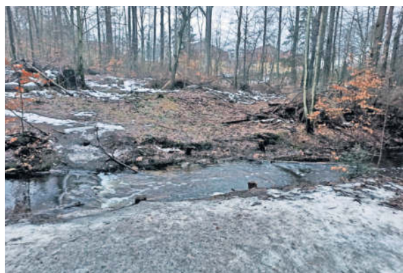
Die marode Holzbrücke wurde vom Sachsenforst aus Sicherheitsgründen entfernt. FOTO: Archiv Fanny Haase
