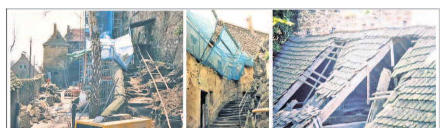
Schloss Klippenstein zu Beginn der Sanierung 1993: li. Fürstenreitreppe, Unterer Schlossohof; Mitte Vorburg / Aufgang zur Hauptburg; re. Dach der Vorburg
