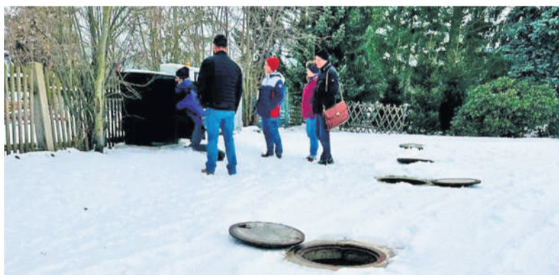
Die Anlage wurde am 22. Januar abgenommen.
