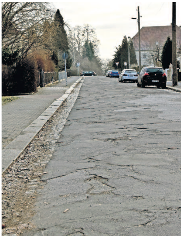
Die für den Durchgangsverkehr größte Einschränkung wird die Vollsperrung der Schillerstraße am Kreuzungsbereich Goethestraße sein. Diese ist derzeit für den Zeitraum 20.03. bis 12.04.2024 geplant. Der Linienbusverkehr wird in dieser Zeit umgeleitet. Bitte beachten Sie die Aushänge an den Haltestellen bzw. die Fahrplanänderungen unter www.vvo-online.de/de/fahrplan/fahrplanaenderungen .
