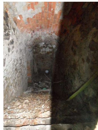
Foto 6: Zugangsbauwerk des Eiskellers von innen, die Tonnengewölbe gehen nach rechts und links ab
