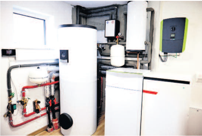
Heiztechnikraum mit modernster Erdwärmepumpentechnik © Intelligent heizen / Bjoern Luelf
