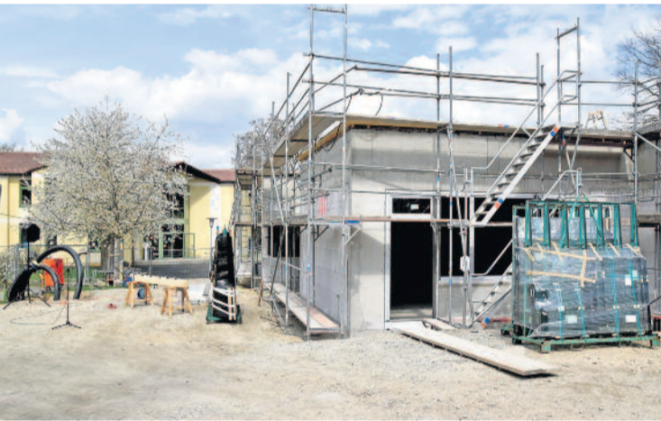
Der Neubau des Hortes der Heideschule nimmt Form an. Im Herbst könnte das Gebäude bezugsfertig sein.
