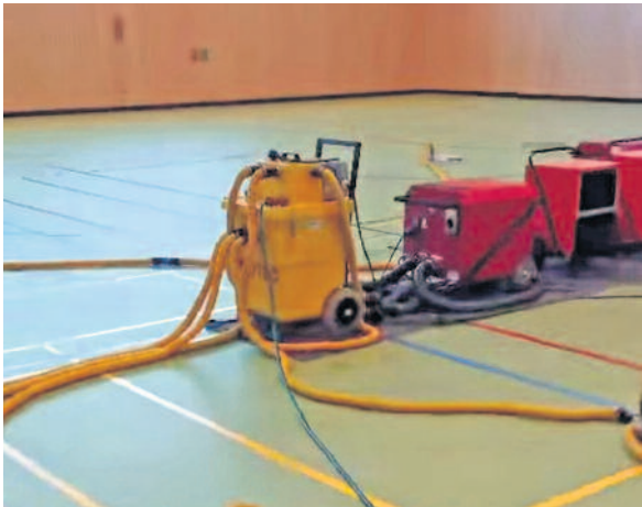
Das Wasser lief bis unter den Sportboden. Die Trocknung läuft derzeit.
