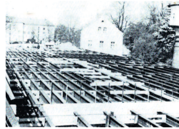
Neubau der Bahnbrücke mit Blick in Richtung Rathenastraße. Rechts ist ein Stück des Wasserturmes zu sehen.
