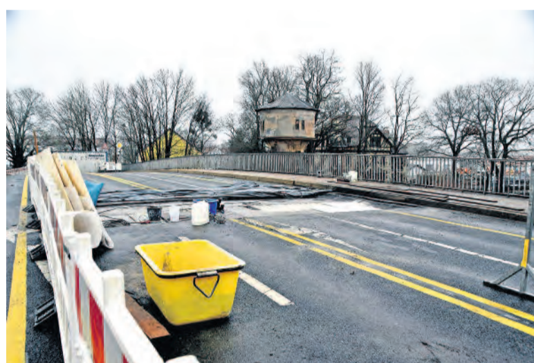
Eine Untersuchung folgt der nächsten. Wird die Brücke über die Eisenbahnstrecke in Radeberg noch einmal befahren werden können? Ergebnisse werden im Frühjahr erwartet.
